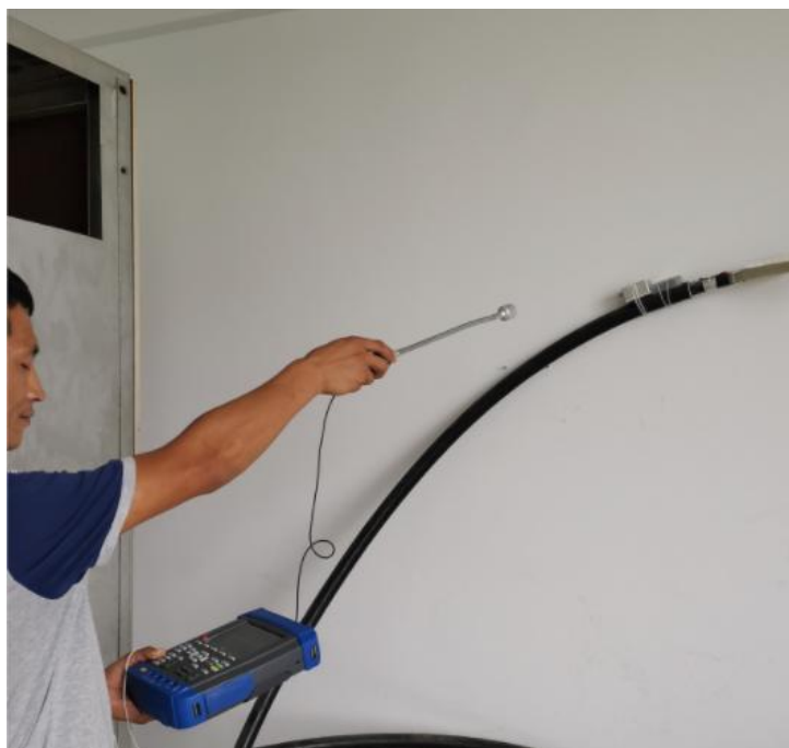
使用手持式非接触式超声波聚能器扫描高压电缆
